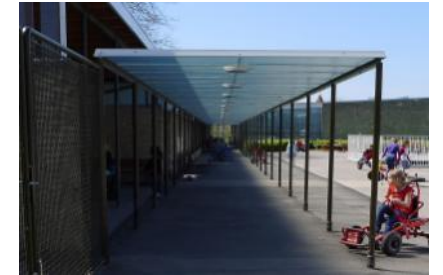
Munkegårdarmaturer indbygget i Pergola Munkegård light fittings integrated into the pergola
