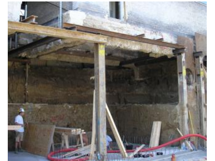
Byggeri, der er gravet ind under bygninger Construction, digging in under buildings
